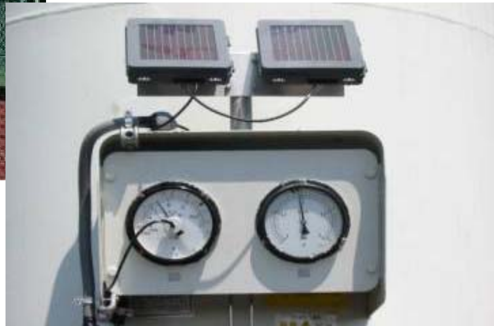
液化ガス貯槽の 遠隔液面監視システム
