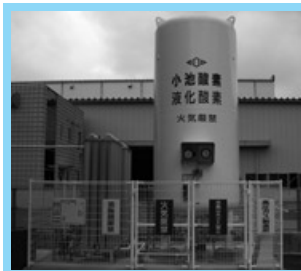
CE（超低温液化ガス貯槽）
